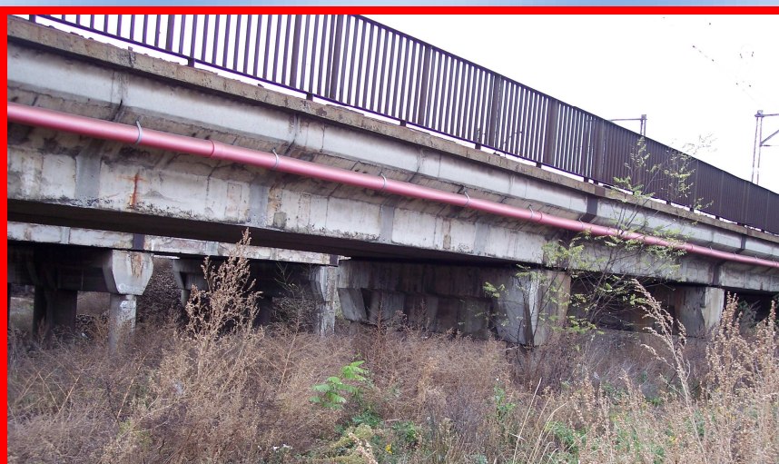
Dworzec Wschodni – istniejące wiadukty kolejowe (widoczne są liczne uszkodzenia)
