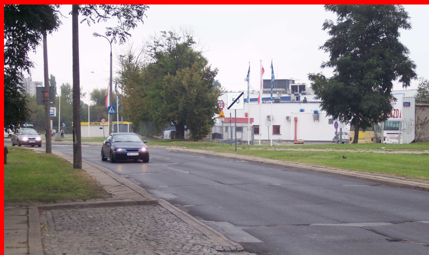
Ul. Stalowa - istniejąca nawierzchnia jest zniszczona, skoleinowana, z licznymi spękaniem i ubytkami, w których gromadzą się wody opadowe
