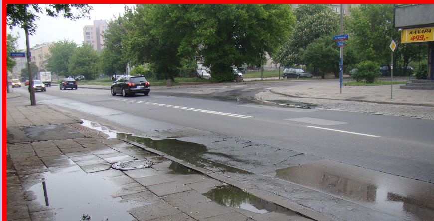
Ul. Św. Wincentego - istniejąca nawierzchnia jest zniszczona, skoleinowana, z licznymi spękaniem i ubytkami, w których gromadzą się wody opadowe
