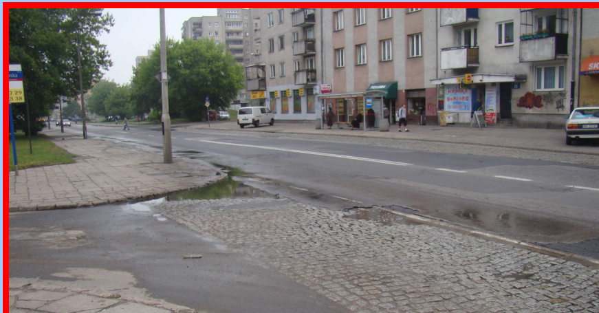
Ul. Św. Wincentego - istniejąca nawierzchnia oraz ciągi piesze są w złym stanie technicznym, brak ścieżek rowerowych
